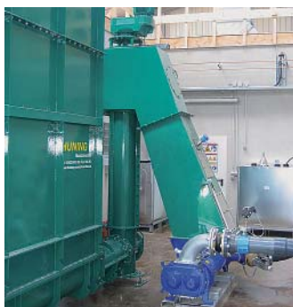
Trasferimento del dosatore di sostanze solide nei sistemi di pompaggio
