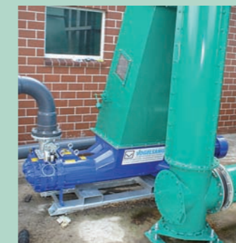
Toevoeraansluiting aan een hydraulisch druktransport met voorverkleiningsseenheid
